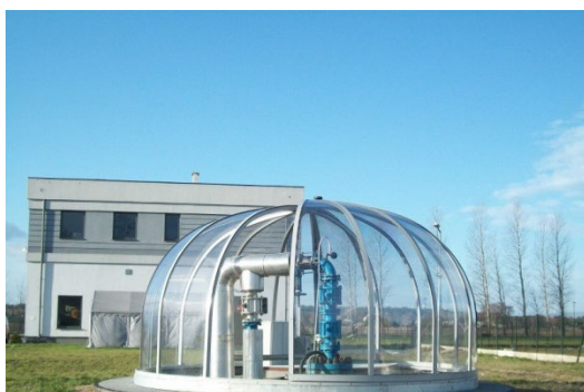
Obr. Geotermia Poddębice
