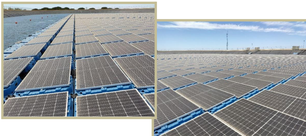
Immagine 2: Vista dettagliata dell'impianto fotovoltaico galleggiante
